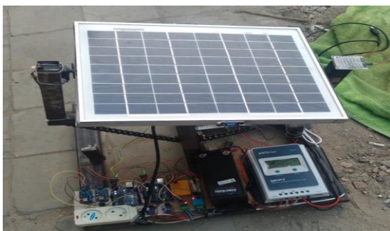
Gbr. 4 Hasil Instalasi Perangkat Monitoring Panel Surya
