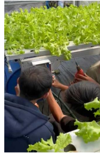
Gambar 7. Pemasangan alat smart greenhouse
