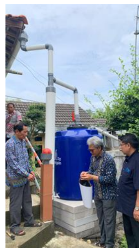
Gambar 3. Instalasi Penampungan dan Penyaringan Air Hujan
