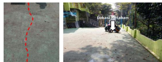
Gambar 2. Kondisi Lereng akibat Longsor dan Retakan pada Lapangan Terbuka SMP Al-Husainiyyah
