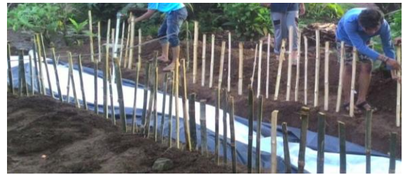
Gambar 6. Demplot Biogas dari Kotoran Sapi Lokasi 3
