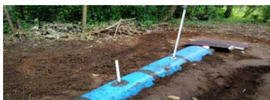
Gambar 4. Demplot Biogas dari Kotoran Sapi Lokasi 1
