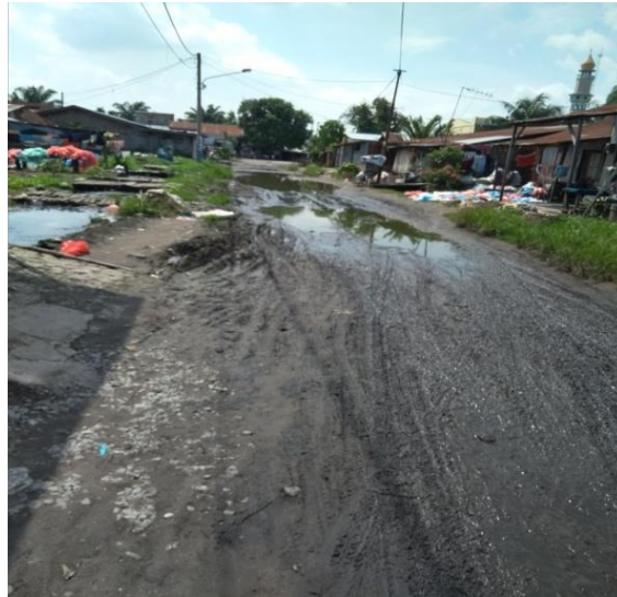
Gambar 2. Kondisi Jalan Lingkungan
