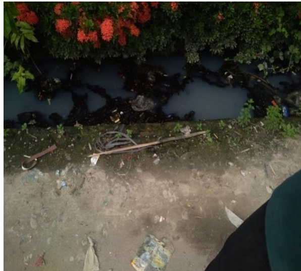
Gambar 3. Kondisi Drainase Lingkungan
